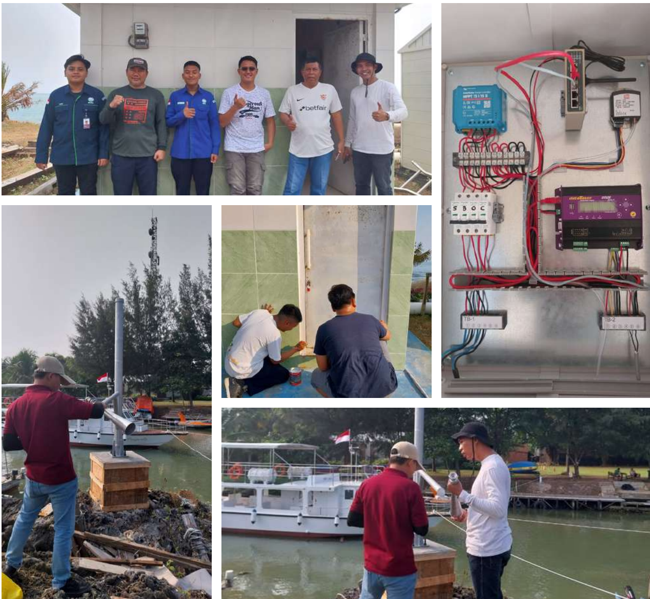
Gambar 34. Dokumentasi Pemasangan Peralatan Tsunami Gauge di Provinsi Banten
